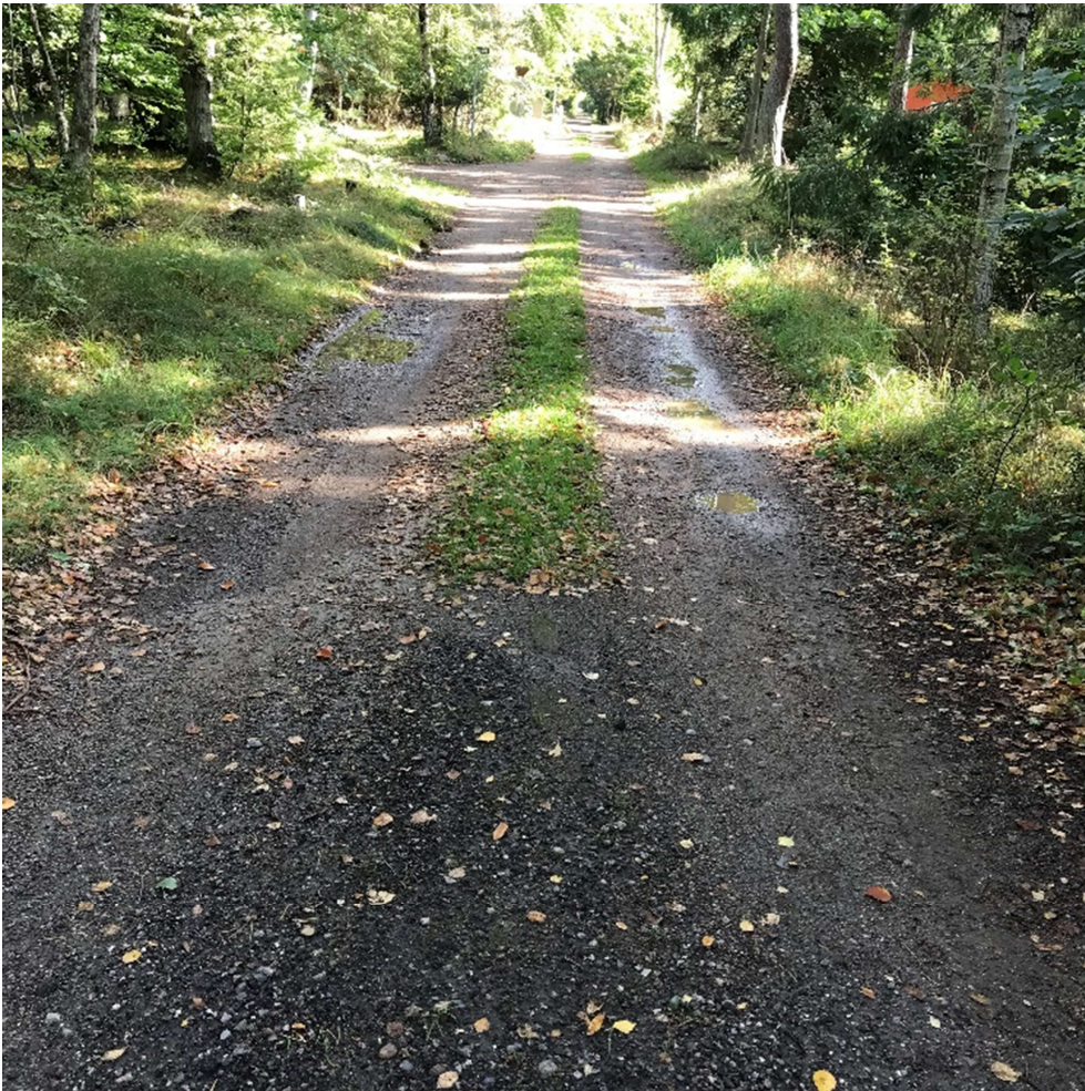
Foto 4: Mellemvej østlige del har områder hvor vandet ikke kan løbe væk.
