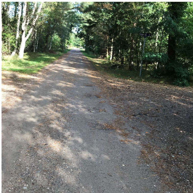
Figur 2: Enkelte huller i Klitborgvej.
