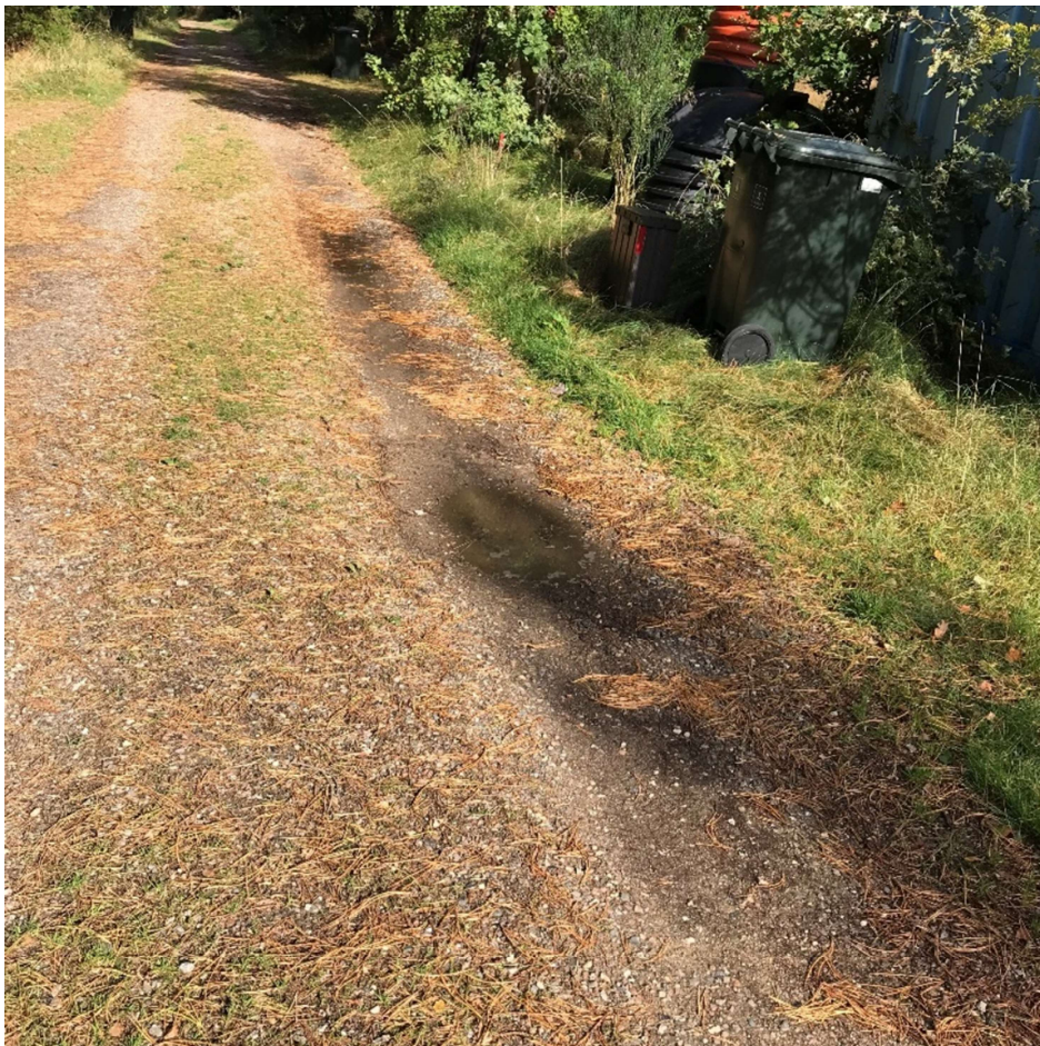
Foto 8: Klitvej har afvandingsproblemer enkelte steder.
