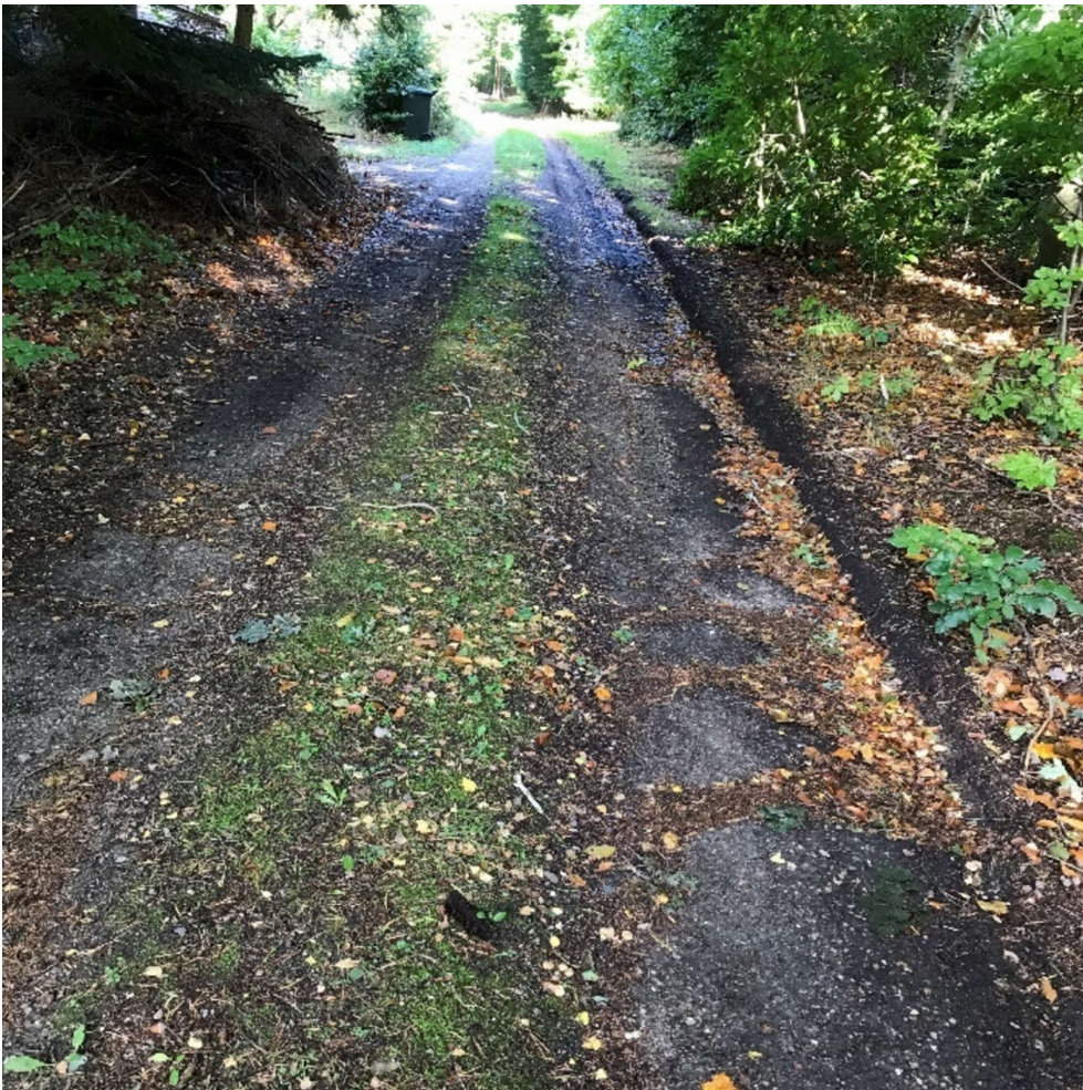
Foto 5: Agernvej har et stykke på ca. 50 m hvor vejen ikke kan bære trafikken.
